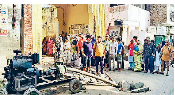
भिवानी। पतराम गेट गोशाला के सामने सीवरेंज मैनेजमेंट की सफाई के लिए रखा जनरेटर व विरोध जताते क्षेत्रवासी। फोटो: हरिभूमि
